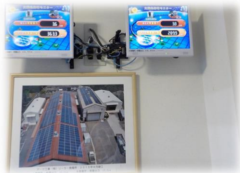
発電量のモニターチェック
